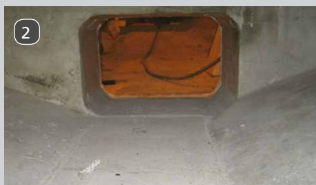
2 \ Channel between melting and holding chambers Canal de comunicación entre cámaras
