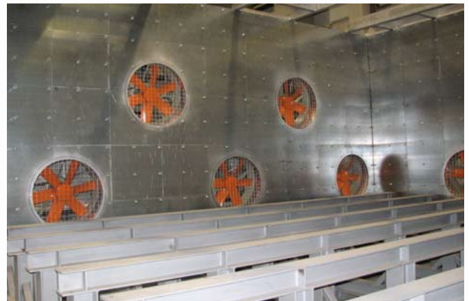
\ Cámara de enfriamiento forzado (aire).
