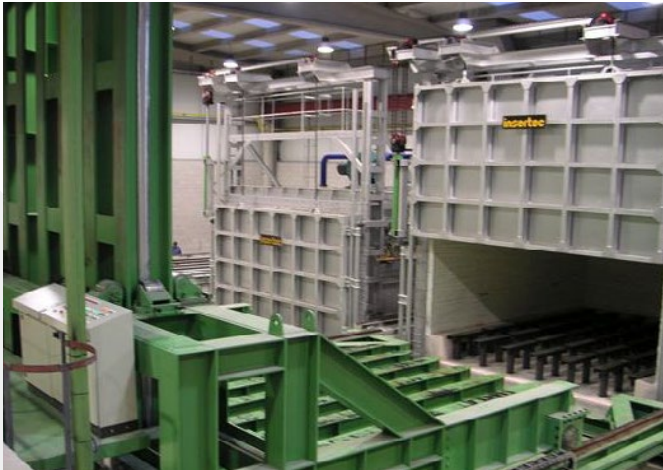
\ Vista general Instalación de tratamiento térmico.
