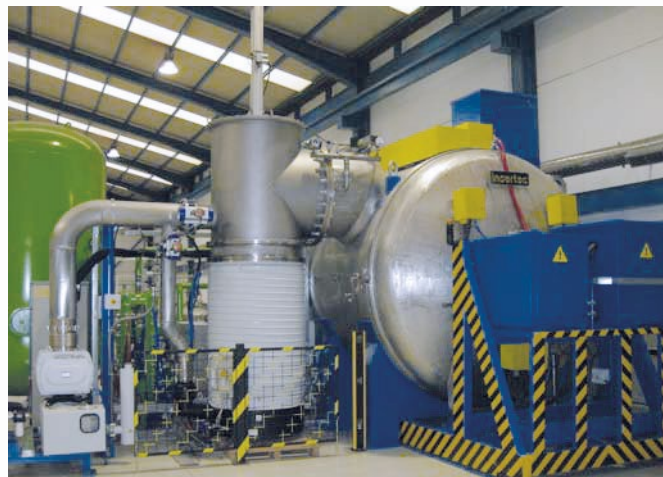
\ Horno de vacío para brazing con bomba difusora.
