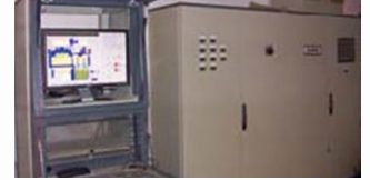
\ Armario eléctrico con sistema informático.
