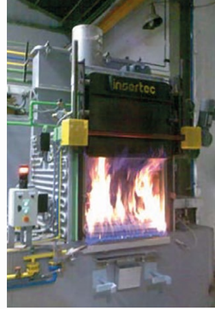
\ Vista puerta descarga horno.
