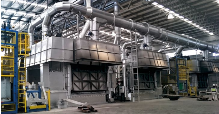
\ Reverbero pozo lateral en refinería
