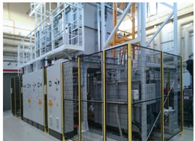
\ Instalación de dos hornos con tanque de agua. Común a ambos
